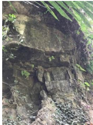
圖 1-3 有地下水滲出、岩壁中有長植物，因此地質較脆弱。
