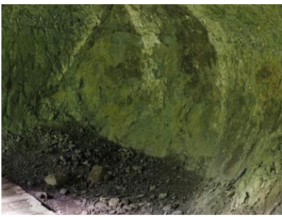
圖 1-14 燕子崖底部凹壁內有很多的崩塌。
