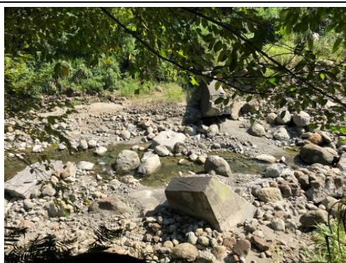
圖 1-5 河床上的防砂壩被水沖壞，斜躺在河裡。因為較大的石頭被擋在上一個防砂壩，所以這裡的石頭都不太大。
