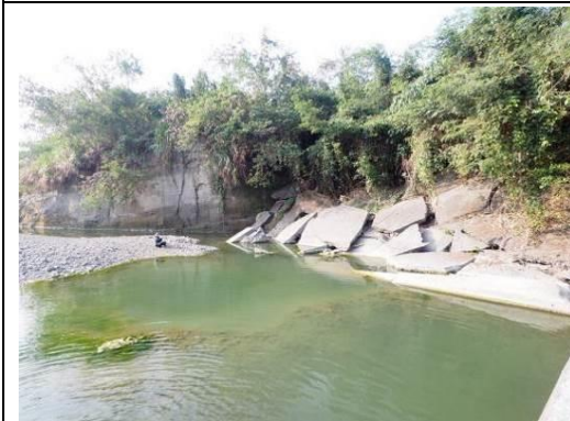
圖 1-56 因為河流侵蝕得太嚴重，仁義潭橋西岸北邊的護岸水泥幾乎都被破壞。
