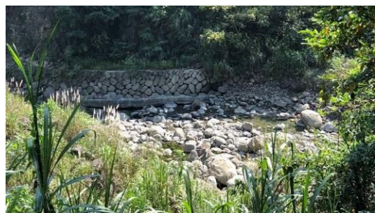
圖 1-3 東邊的河岸是用鐵絲網編成長方形的籠子，裡面放入鵝卵石，把河岸圍起來的蛇籠，避免河岸被沖垮。
