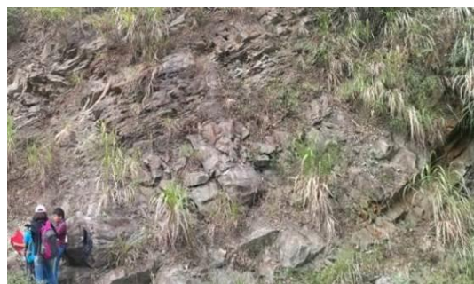
圖 1-55 砂岩、頁岩相互堆疊的砂頁岩互層，岩層破裂崩塌；碎裂的石塊堆積在下方，顆粒不大，碎屑較多。
