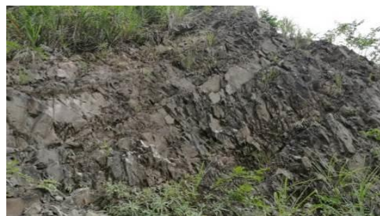
圖 1-26 層面為褐灰色砂岩夾雜黑色頁岩，表面破碎嚴重節理明顯，上層多塊狀砂岩。
