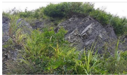
圖 1-26 砂頁岩互層，崩塌面不整齊，可以看到差異侵蝕。這裡的層面凌亂不明顯，崩塌下來的塊力不大，稜角很清楚，下方的岩層是塊狀砂岩。
